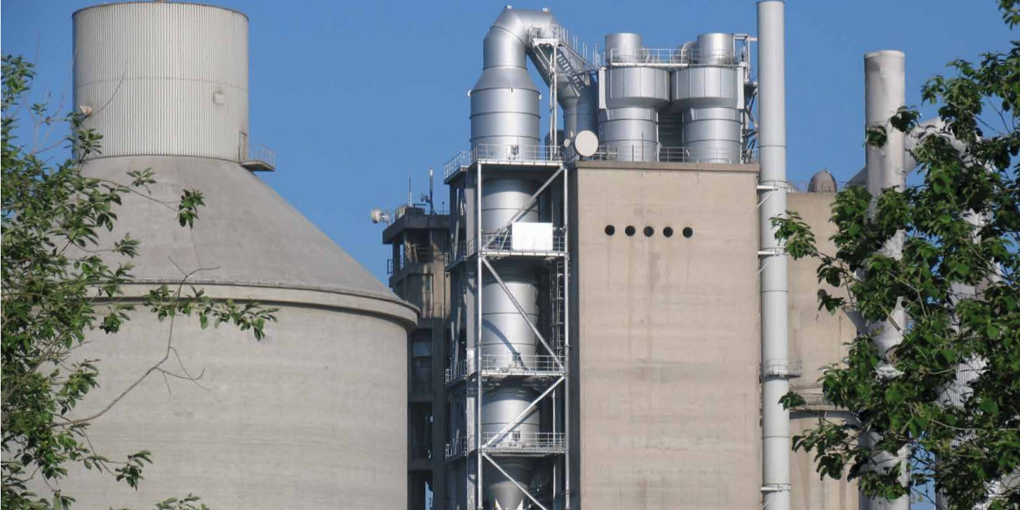
Teil der Abluftanlage des Zementdrehofens und Klinkersilo
